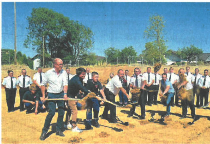
Mit einem symbolischen Spatenstich begannen die Arbeiten am neuen Feuerwehrgerätehaus in Stadt Blankenberg. Foto: Lorber
